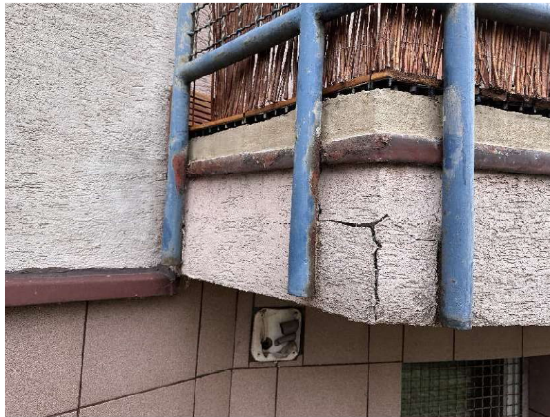
Widoczne miejscowe ogniska rdzy na balustradzie balkonu parteru.
