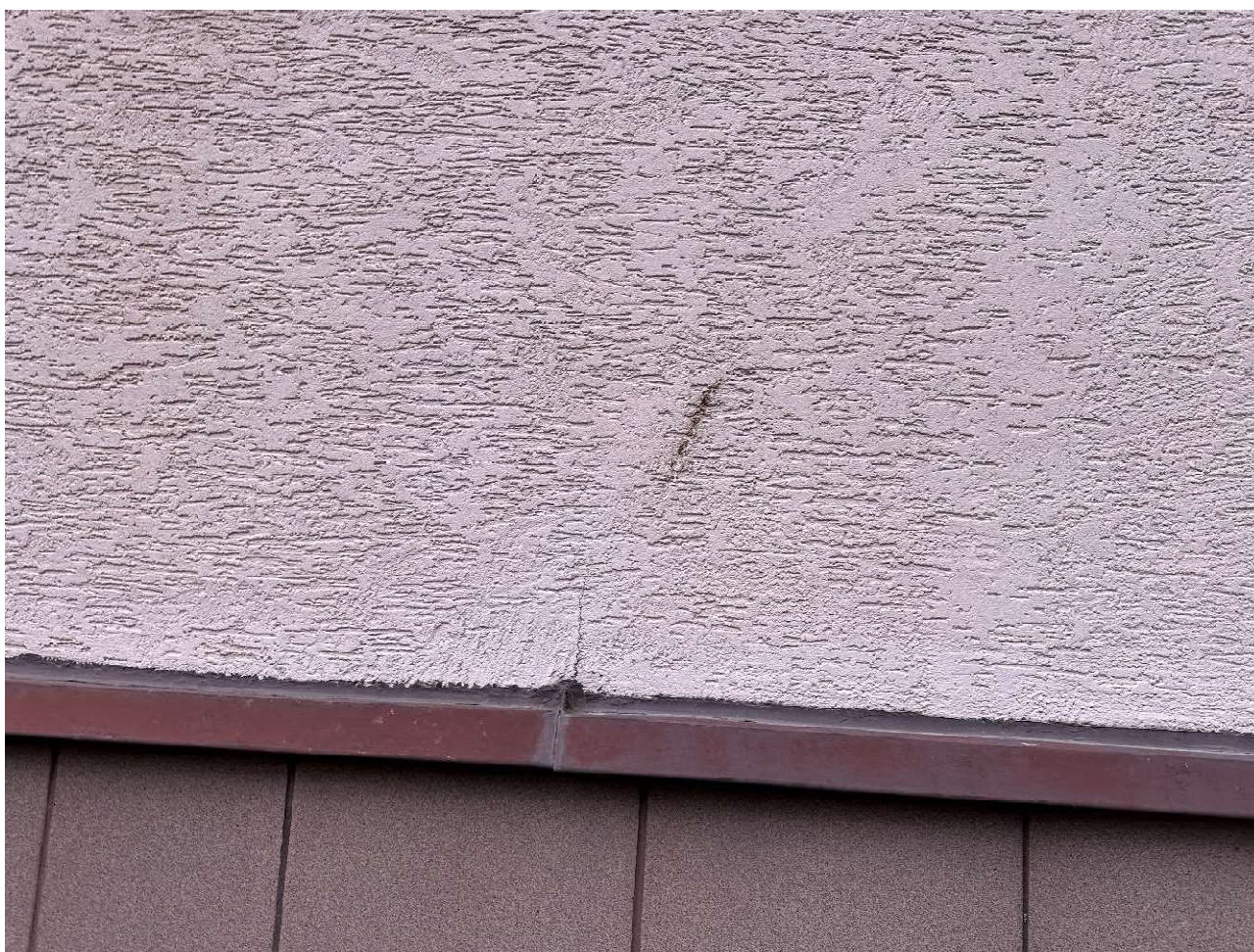
Widoczna łuszcząca się farba na obróbkach blacharskich cokołu oraz utrata szczelności w miejscu łączenia obróbek.
