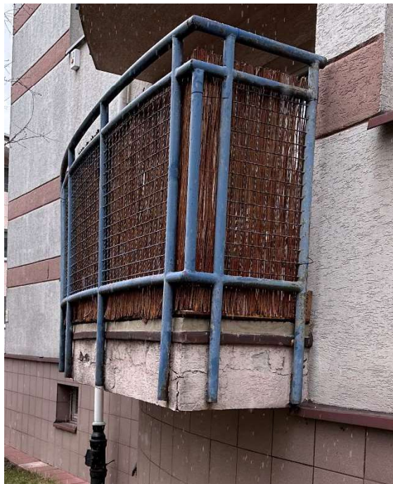
Widoczne miejscowe ogniska rdzy na balustradzie balkonu parteru.
