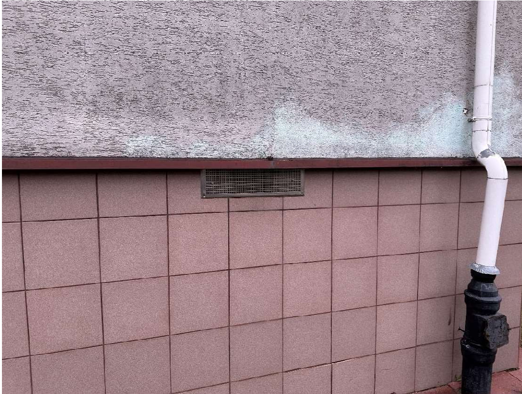
Widoczne 2 płytki odspojone w dolnej części cokołu.
